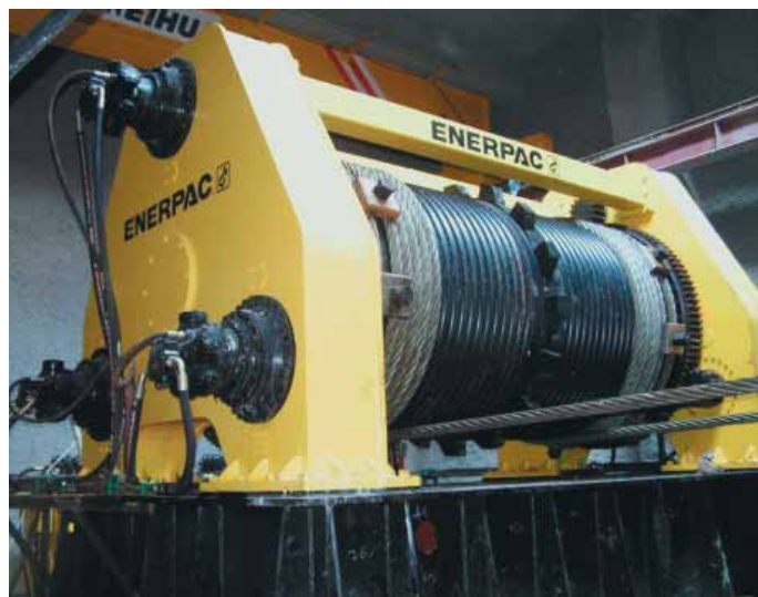
▲ 8 hydraulische Winden ermöglichen das Dach auf Schienen auf- und zuzuschieben
