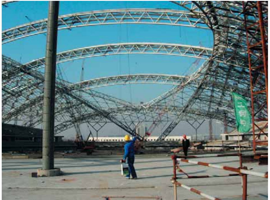
▲ Die 2.200 t schwere, bewegliche Dachkonstruktion aus Stahl des Nan Tong Stadions wird hydraulisch geöffnet und geschlossen. Beide Dachschalen werden mit Hilfe von 44 Laufkatzen und 8 hydraulischen Winden über Schienen bewegt.
